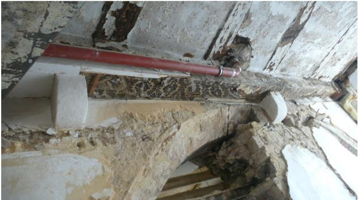
Abb. 9: An der Ostseite des Raums wurde um 1567 für die neue Geschosdecke ein Unterzug eingebaut, der (statisch relevant) auf mehreren Konsolen ruht; eine Konsole (unterhalb eines Deckenbalkens) wurde im Bereich des vermauerten Bogens in das Bogengewände eingestemmt. Die Decke ist offenbar tiefer eingezogen als im mittelalterlicher Zustand, das EG somit niedriger (vgl. die vermauerten Fensteröffnungen an der Fassade). – Das Achteckprofil des Bogens entspricht der Scheidarkade in der 1376 vollendeten zweischiffigen Brüderkirche.
